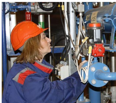
Olivera Golijanin fick prova alla uppgifter på kraftvärmeverket.
